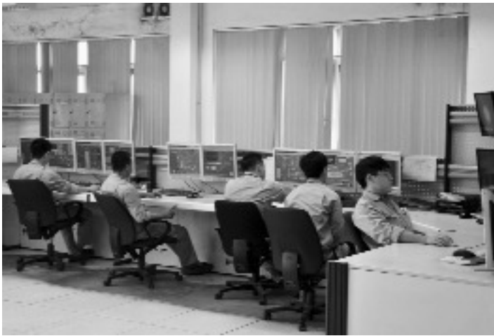
Cán bộ kỹ thuật xi măng Cẩm Phả, trực vận hành tại Trung tâm điều khiển.
